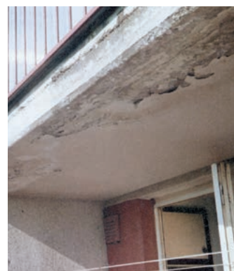
detail lodžie v havarijním stavu
