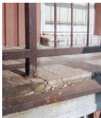
detail lodžie v havarijním stavu
