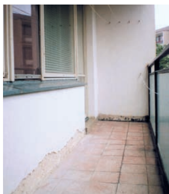
lodžie s nefunkční hydroizolací a soudržnou neglazovanou dlažbou
