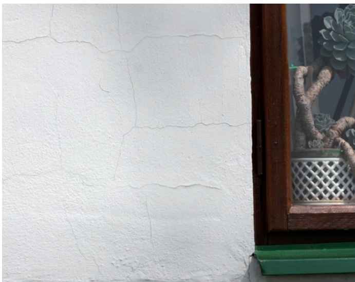
Pohled na stěnu s trhlínkami.
