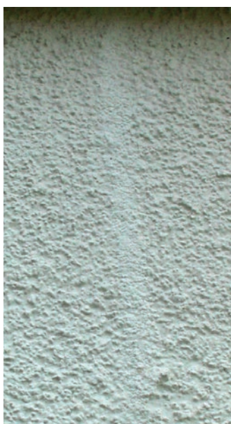
detail trhliny po přetmelení trvale pružným tmelem
