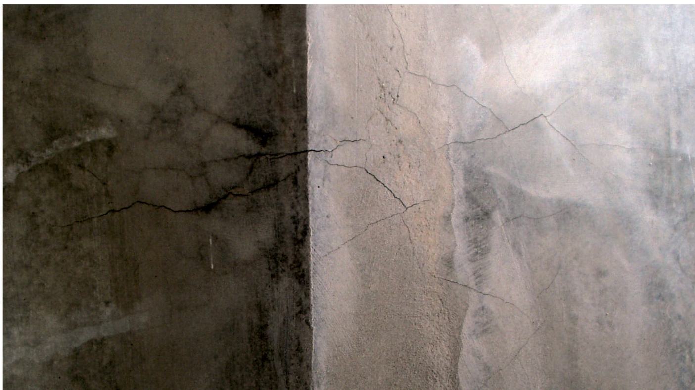
příklad trhlin vhodných k sanaci ETERNAL elastem
