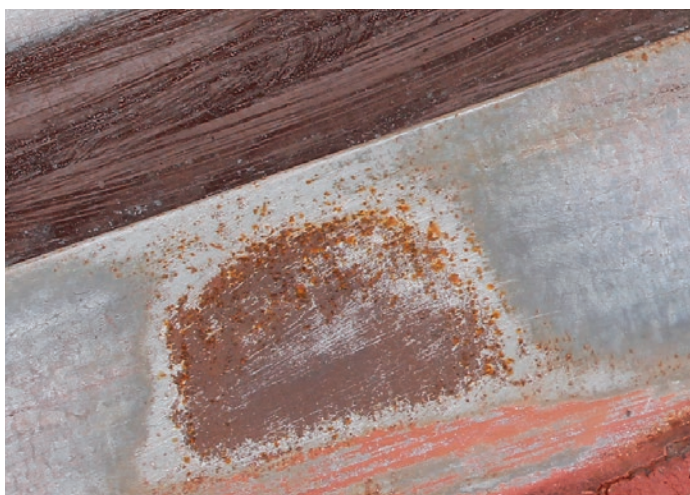
Korozi napadený pozinkovaný plech
