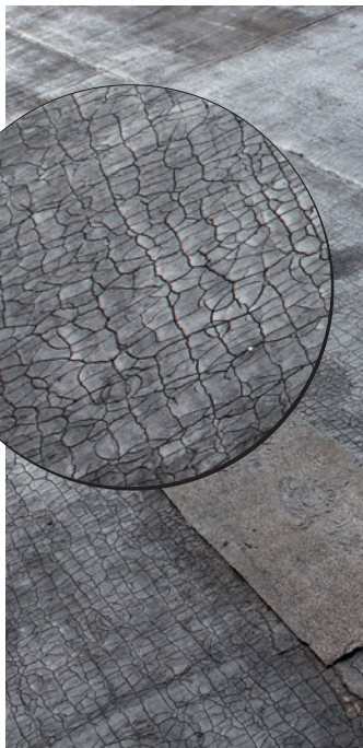
Detail popraskané, ale soudržné krytiny z asfaltových pásů.
