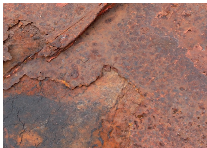
Hloubková koroze plechové krytiny
